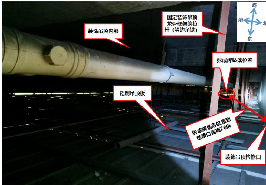
图 14 事发装饰吊顶内部勘查图
