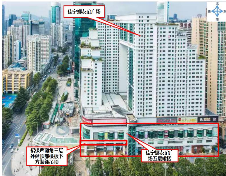
图 2 事故发生装饰吊顶位置情况勘查图
